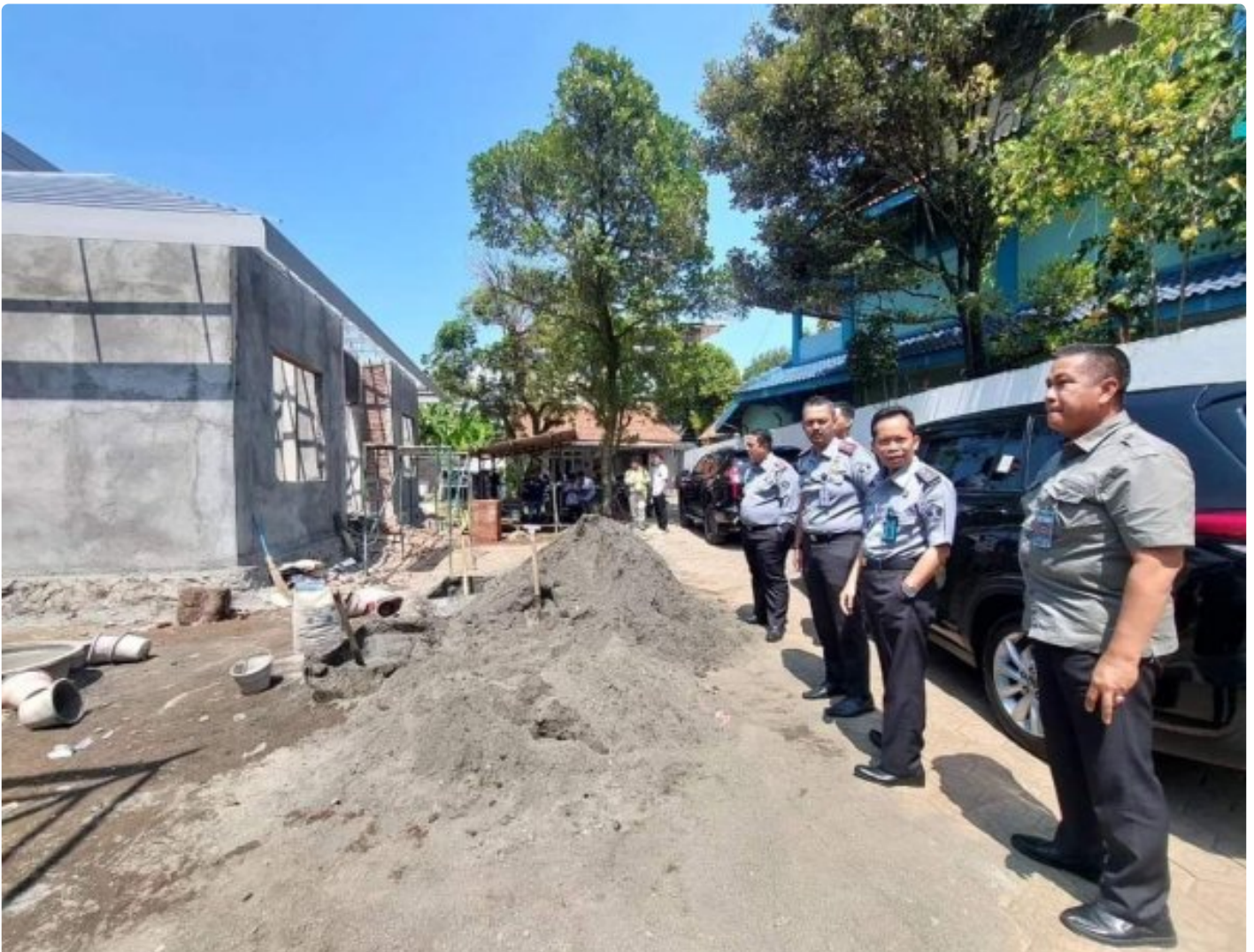
Kadivmin Kemenkumham Jateng Hajrianor Pantau Progres Pembangunan dan Renovasi Rumah Dinas Kanim Kelas I TPI Cilacap
